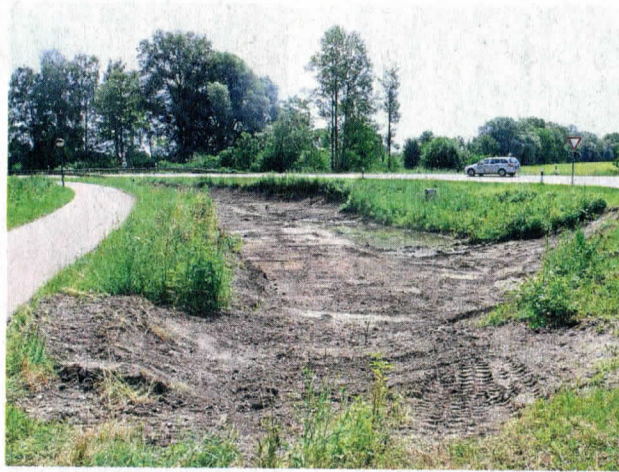
Hier soll der Kreisverkehr entstehen: Erste Oberbodenarbeiten fanden bereits statt. FOTO: WEBER
